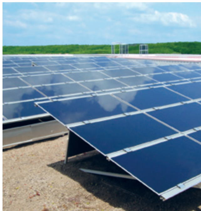
Photovoltaikanlage dm-Verteilzentrum Weilerswist.
